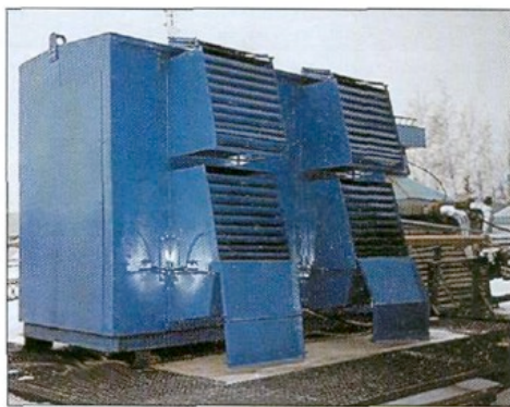
Рис. 1. Аппарат воздушного охлаждения АВОМ 210.5.6 п-П на площадке КС «Мышкинская».
